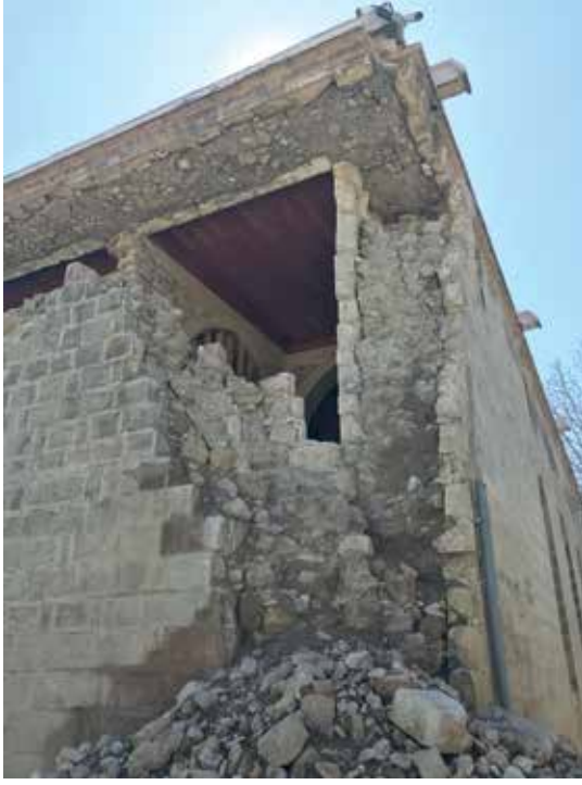
Şekil 15. Adıyaman Mor Petrus ve Mor Paulus Kilisesi kuzeydoğu köşesinde hasarlar.
