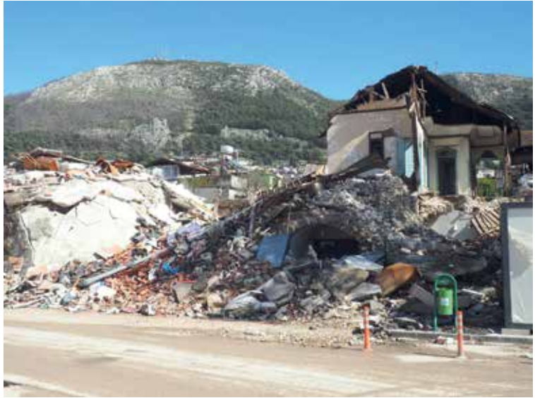
Resim 17. Antakya Kurtuluş Caddesi’nde birbirinin içine geçmiş yapı enkazları.
