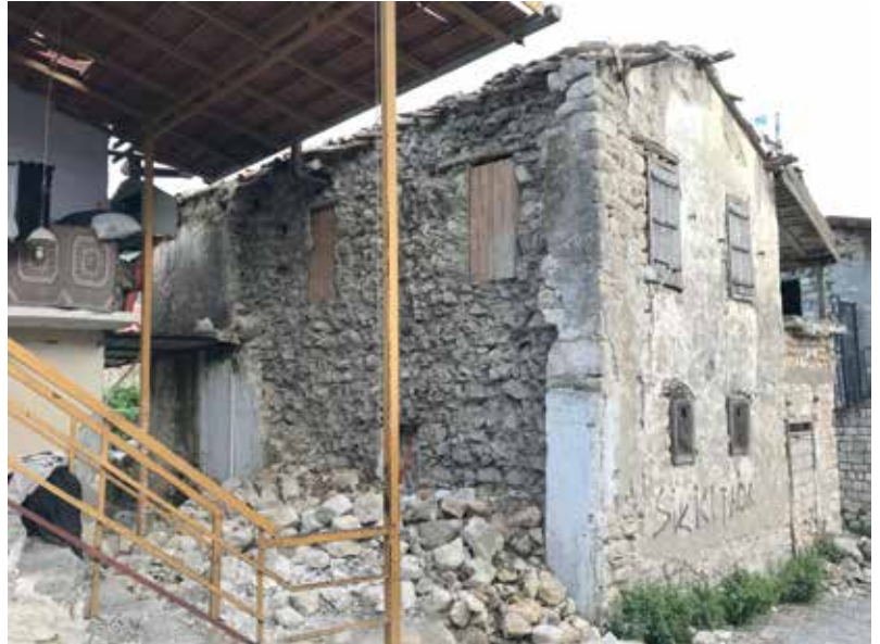
Şekil 14. Hatay, Samandağ, Hıdırbey Köyü’ndeki bir yapının kâgir duvarında görülen hasarlar.
