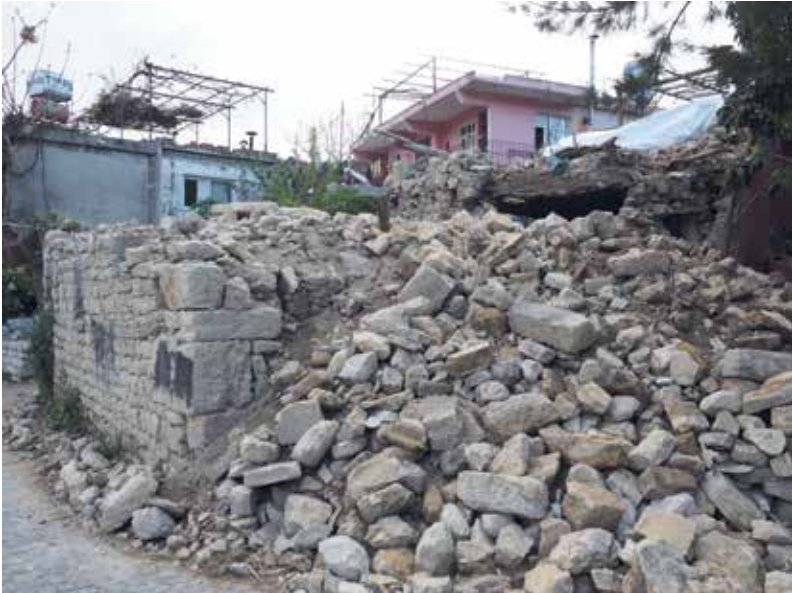
Şekil 12. Hatay, Samandağ, Hıdırbey Köyü'nde yıkılmış taş yapı.
