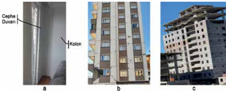
Resim 3. Duvarların kolonlar arasına örülmemesine ve bu durumun depremdaki davranışına ait örnekler (Osmaniye).
