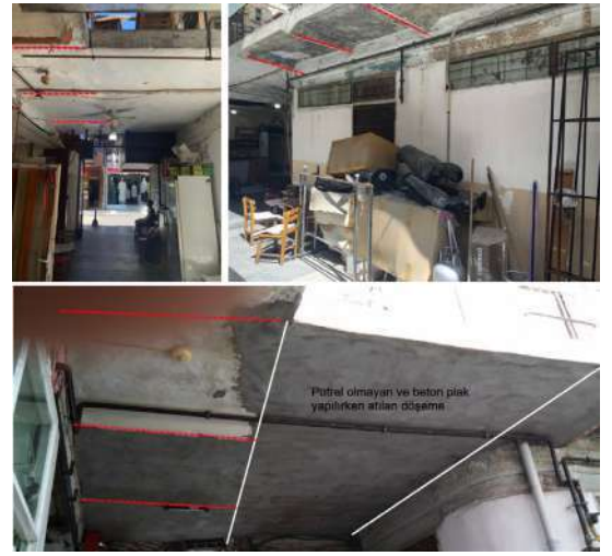
Resim 21. I ve L bloğun ayrı olan teraslarının beton plak döşeme yapıldığı sırada birleştiğini gösteren kanıtlar (Yazar arşivi).
