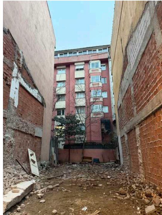
Resim 1. Acıbadem’de kentsel dönüşüm sonucu önündeki binanın yıkılmasıyla "Geçici Manzara"sına kavuşan bina, Şubat 2026, Duygu Yarımbaş.
