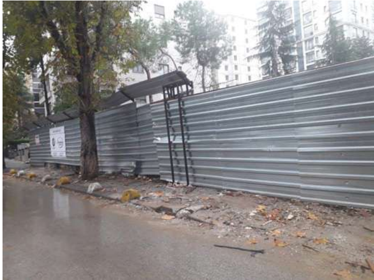
Resim 3. Kozyatağı, Ressam Şevket Sokağı, Şantiye önünde düzensiz kaldırım. Ebru Firidin arşivi, Kasım 2025.
